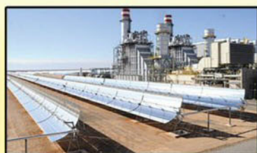
Centrale Thermo Solaire d'Ain Beni Mathar
